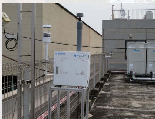
主要地点に設置した粉塵計
