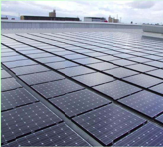
太陽光パネル
